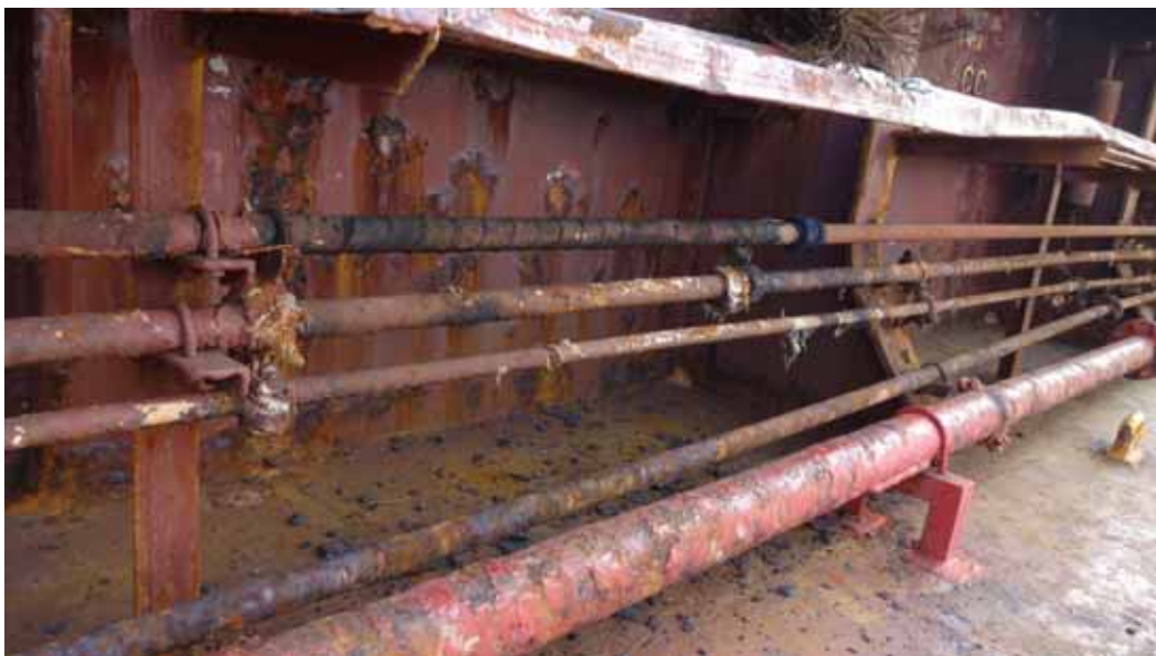
圖2.5 | 艙口圍板和甲板管系處於不良狀況。
