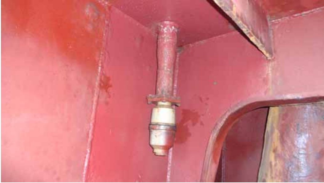
圖2.3 | 排水回水管的防火帽缺失。
