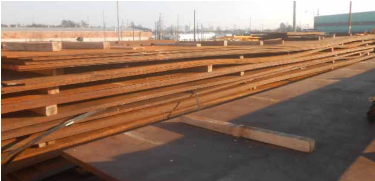
圖5.23 | 變形的鋼板。請注意，襯墊物未正確垂直放置，且水準間距過大。
