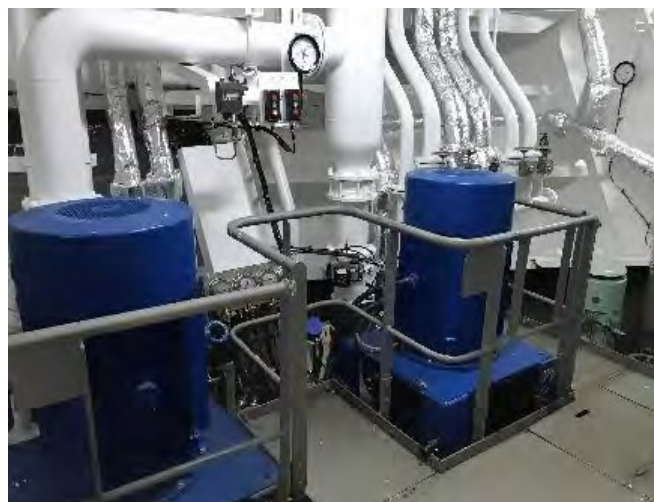
图 3.5 | 机舱的洗涤塔系统所使用的海水泵
