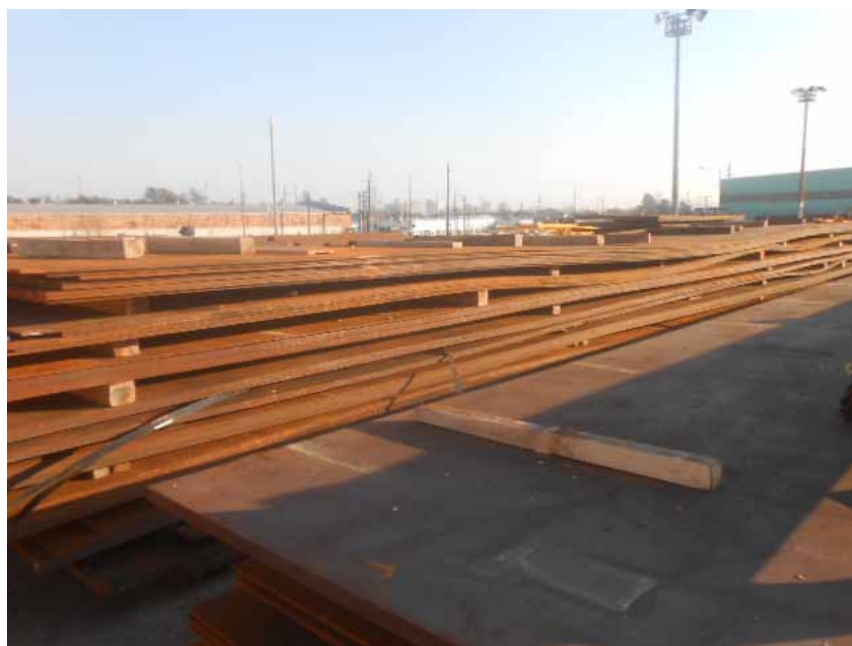
图5.23 | 变形的钢板。请注意，衬垫物未正确垂直放置，且水平间距过大。
