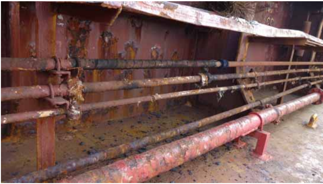
图2.5 | 舱口围板和甲板管系处于不良状况。
