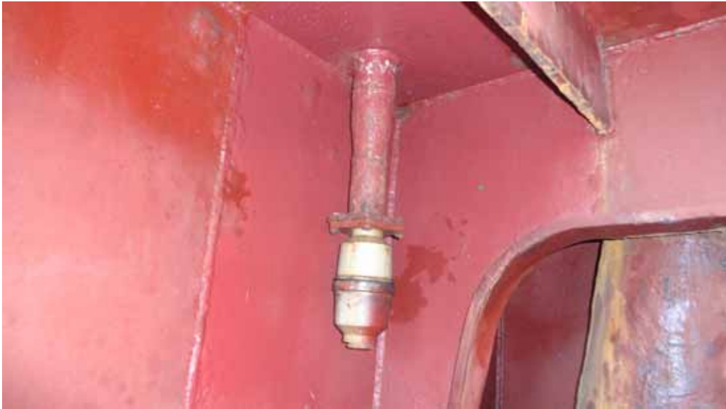
图2.3 | 排水回水管的防火帽缺失。
